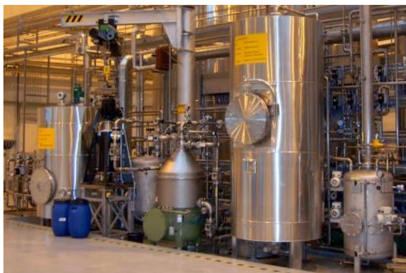
Рисунок 2 – Биогазовая установка производства Германии
