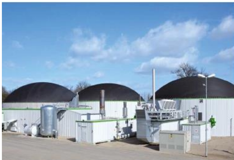
Рисунок 3 – Биогазовая установка Schmack
